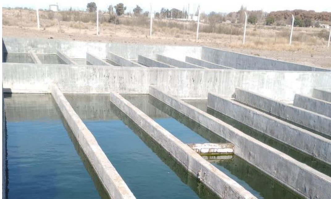
Figura 3: Laguna con agregado de cloro.
