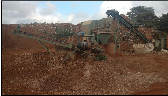
Figura 1. Usina de britagem da areia de RCD. Fonte: Próprio Autor (2018).
